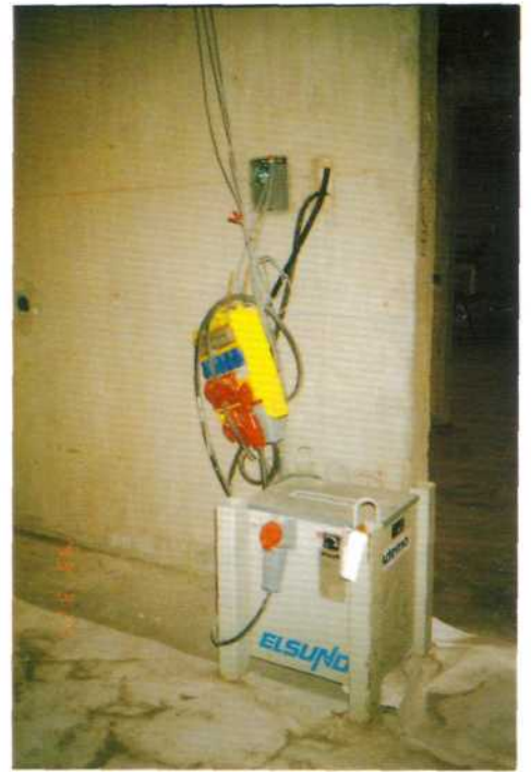
Elförsörjning till varje trapphusplan via specialbeställd kanalisation. Ingjuten svagströmsbelysning. Inga kablar på golvet.
